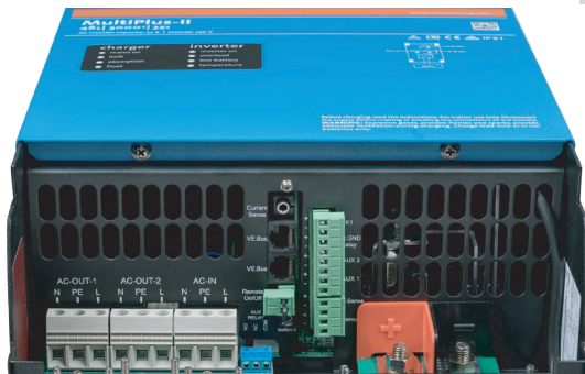
Miejsce podłączenia MultiPlus-II 3k
